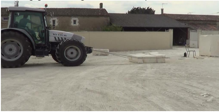
Dégagement des grosses chutes de pierres...
